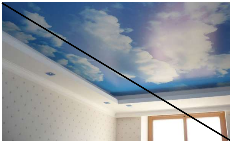
Плохо Натяжные потолки. Потолки с рисунками
