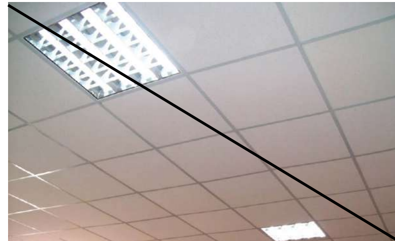
Плохо Открытые направляющие
