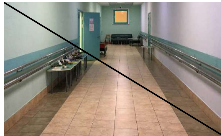
Плохо Керамогранитная плитка с крупными швами
