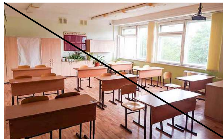
Плохо Линолеум под дерево
